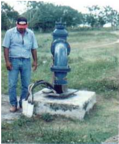
Fotografía 1 Estado actual del pozo 24 de Corozal
