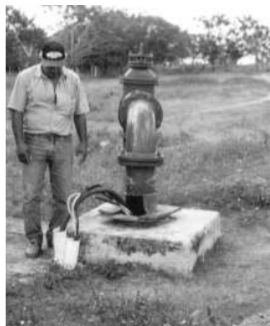
Fotografía 1 Estado actual del pozo 24 de Corozal
